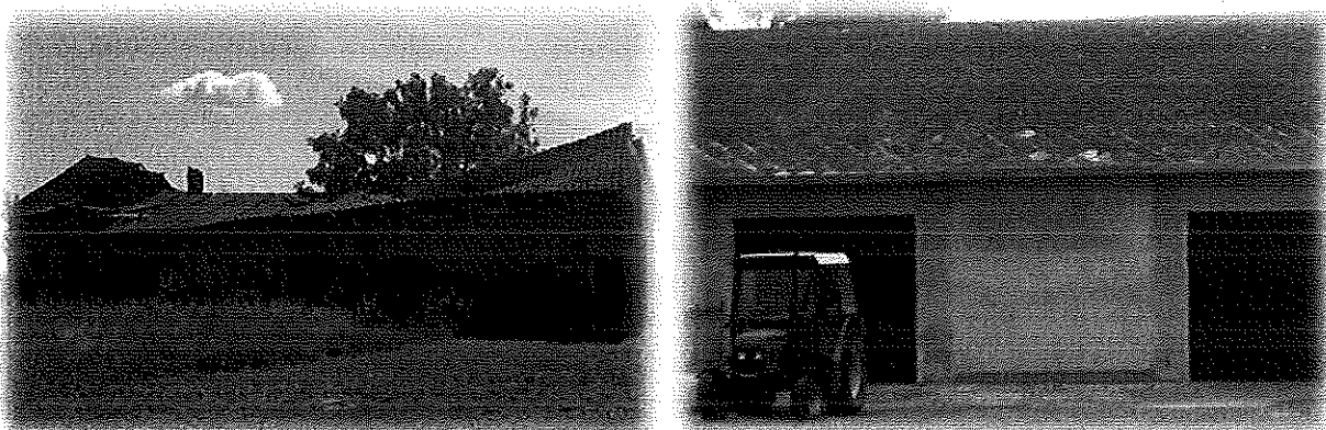
Rysunek 1. Wyroby azbestowo – cementowe: po lewej płyty faliste, po prawej płyty płaskie (źródło: materiały własne).
